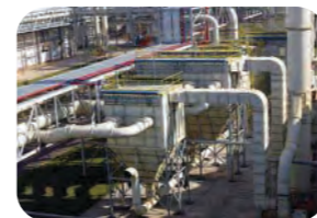
Sistema de despoejamento
